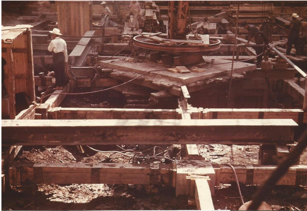
FOTO 7. SOPORTES DE GRÚA DE MONTAJE.
